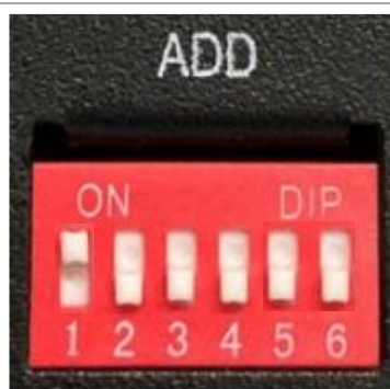
Abbildung 4-5: Bsp. Dip-Schalter BMS Rack 1
